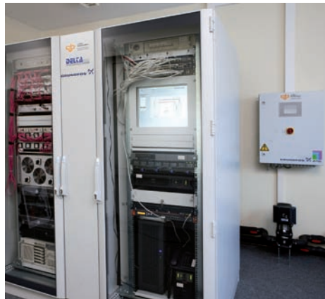
Innovative Anwendung: Erdwärme kühlt EDV-Server-schränke in Celle.
